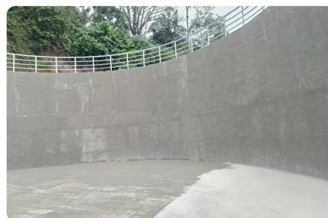
TANQUE AGUAS RESIDUALES 800m3
